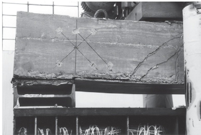
Figura 2 – Tipica fessurazione a taglio di una trave reticolare mista: distacco del fondello e fessurazione inclinata [1].
