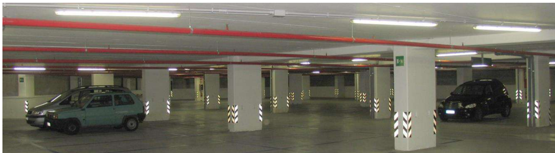
Nuovo parcheggio pluripiano (GE) – Travi PREM a2 su pilastri a N.U.S. pluripiano
