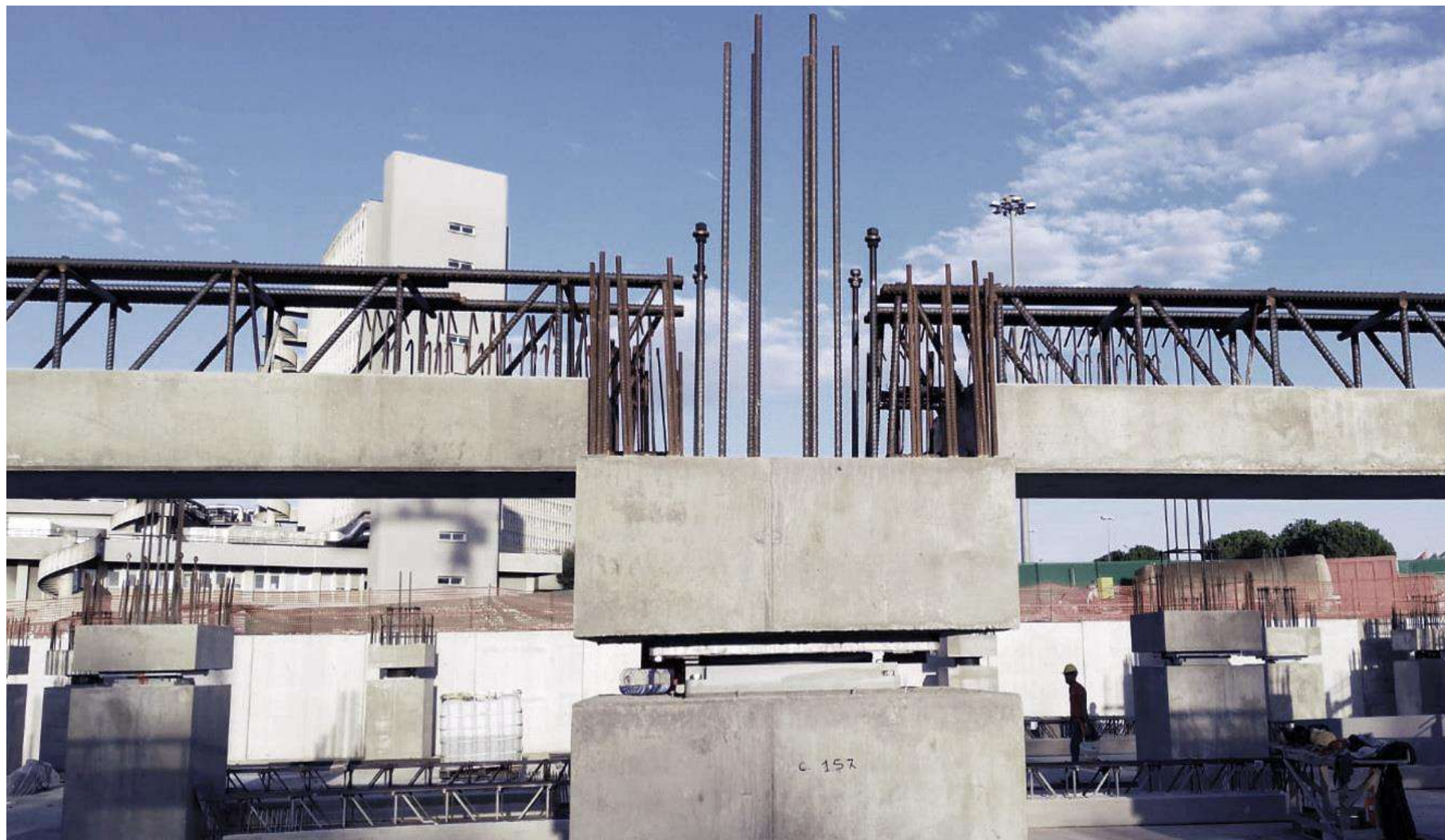
Tirafondi fuoriuscenti da un pulvino, posato su isolatore
