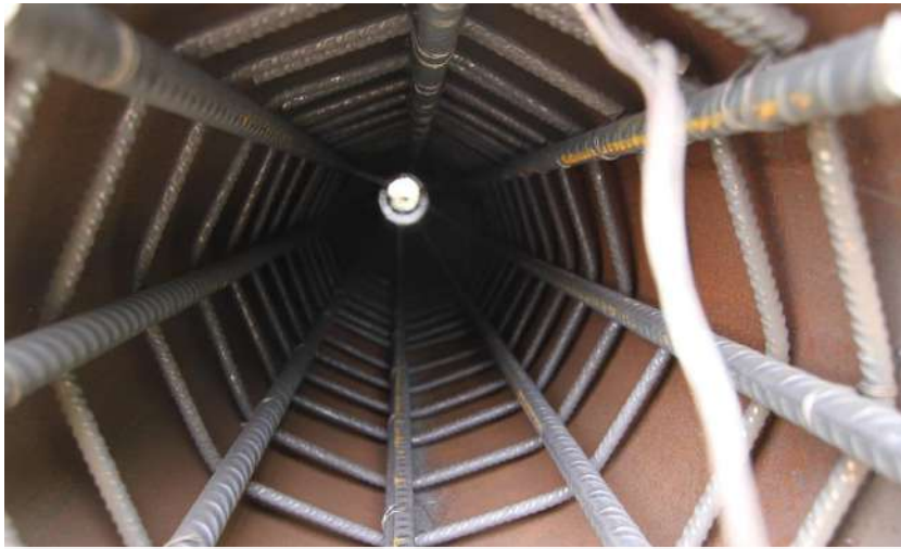
Gabbia interna dei Pilastri Cerchiati Misti
